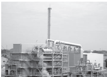
図1. バイオマス発電プラント
